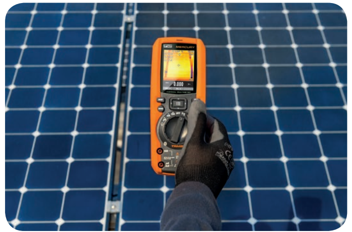
Campo Fotovoltaico: Análisis Termográfico de las células de los paneles fotovoltaicos.
