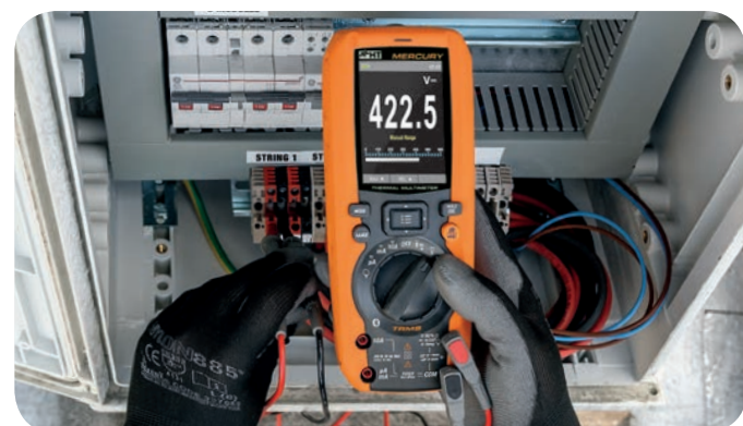
Módulos Fotovoltaicos: Medida de Vmpp.
